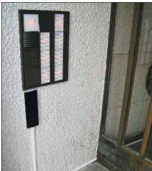
Installerad dörröppnare. Foto: Bostads AB Poseidon
